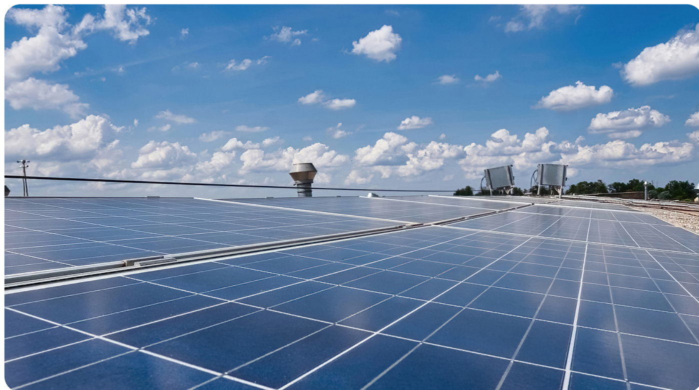
Sui tetti dei cinque stabilimenti del Gruppo Cornaglia sono presenti 14.251 pannelli fotovoltaici per un totale di circa 3.660 kWp
